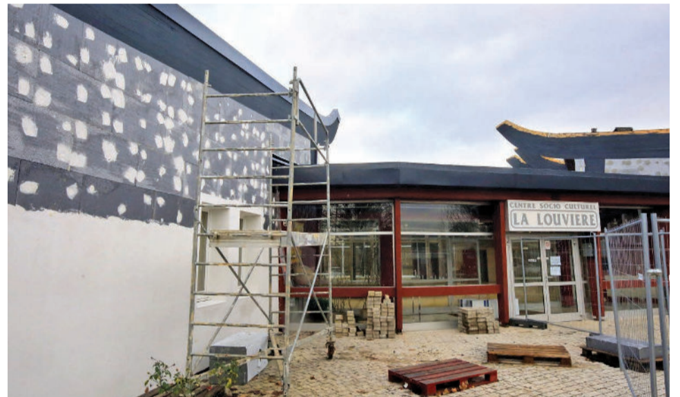
Le coût des travaux d'isolation énergétique réalisés en 2019 au CSC Gilbert Janssem a été de 1,2 millions d'euros
